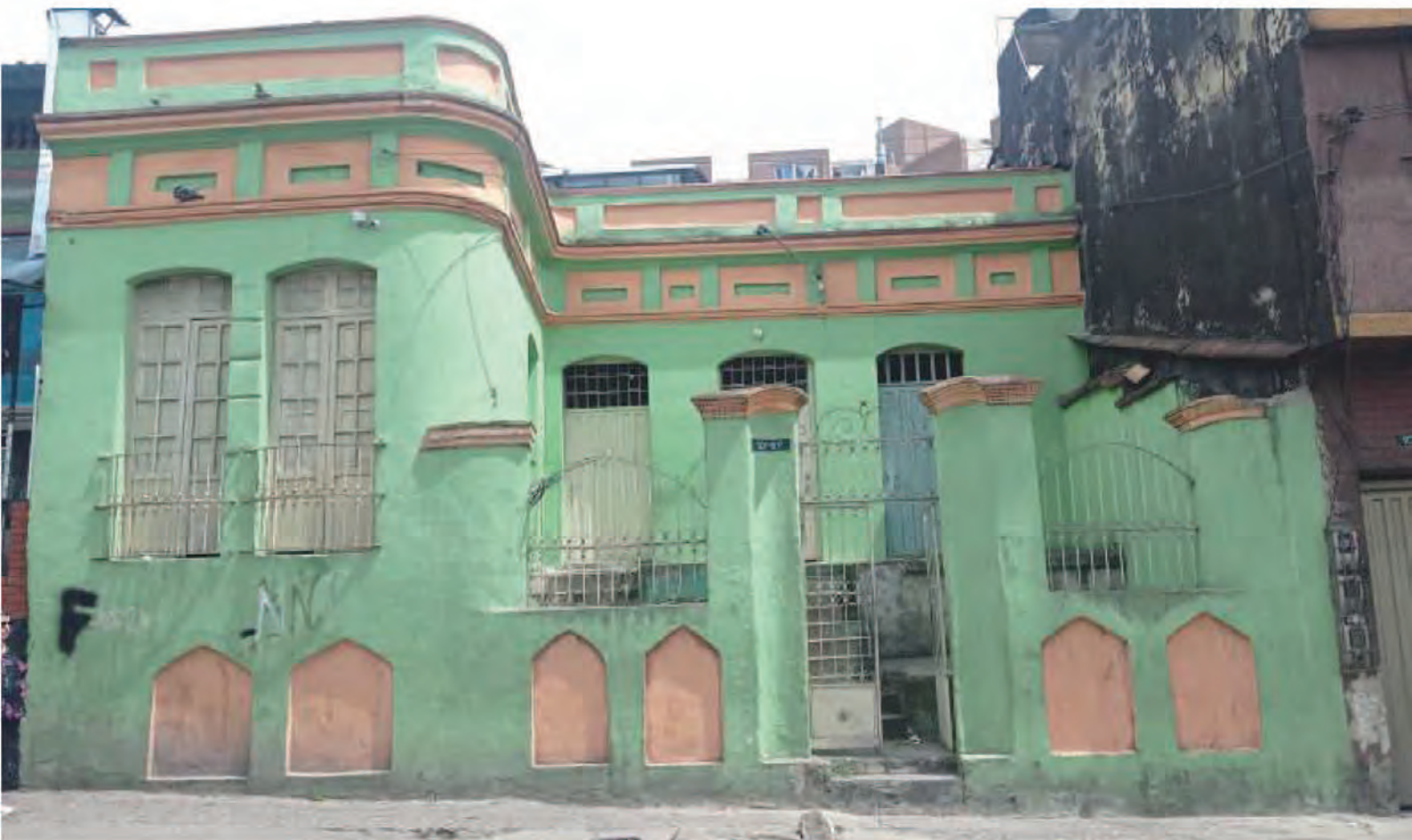
6b. Estado actual de la construcción republicana de un piso, 2022 Imagen: John Jalro Rulz Martínez.
